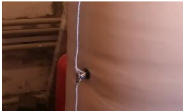
Рисунок 3.14 – Принцип закріплення датчика температури на тепло-акумуляторі
