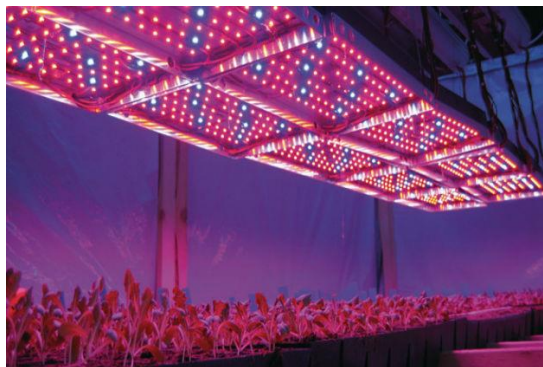
Рис 1.10 – Система штучного освітлення в теплиці
